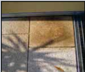
Rostiger Splitt im Unterbau
