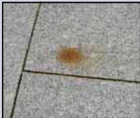
Rostiger Splitt im Unterbau
